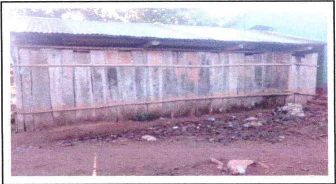
Foto 2: se Observa el deterioro de la estructura modulo 1
